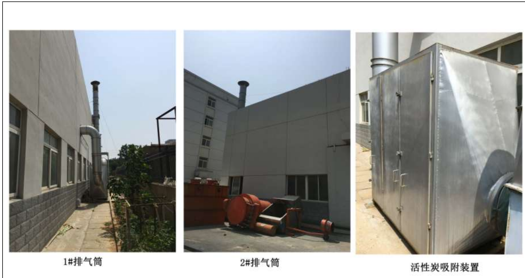
图4.1-4 本项目废气排气筒及废气处理设施现状图
